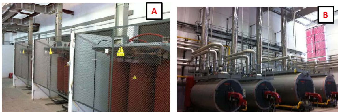
Figura 3:A) Detalle sistema de canalización electrificada y transformadores secos .B) Detalle de sala técnica térmica de calderas, diseñada para las correctas funciones de mantenimiento. Fuente: Elaboración propia.
